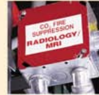
Cajas de conexión
