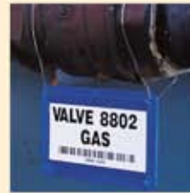
Etiquetas de Válvulas
