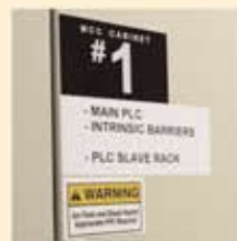
Paneles/Control de Motores
