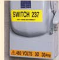
Identificación de Paneles y Switch
